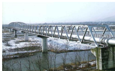
水管橋（雫石川水管橋）
